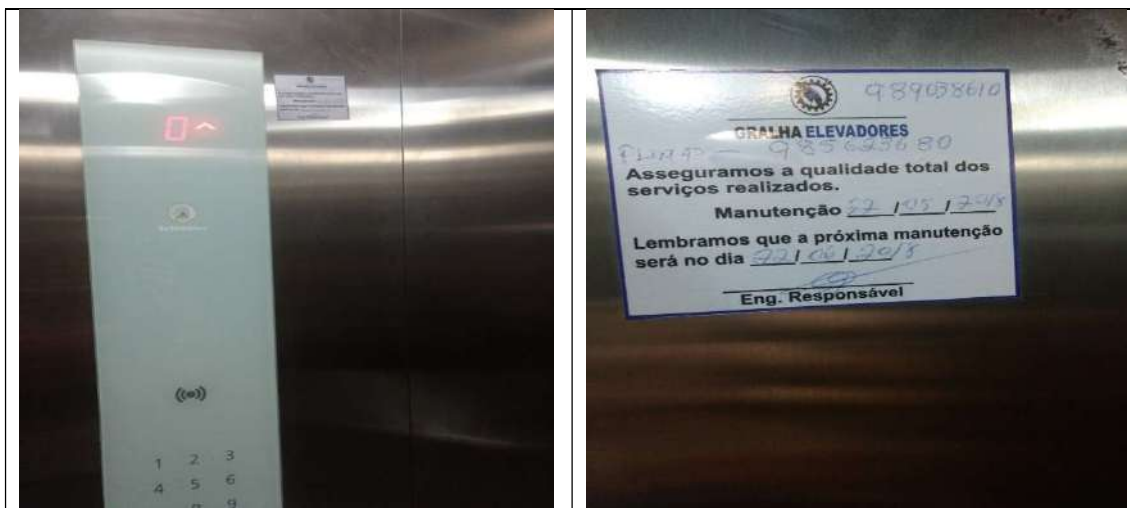
Elevador em funcionamento
